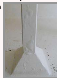
Cloques sur les piliers
